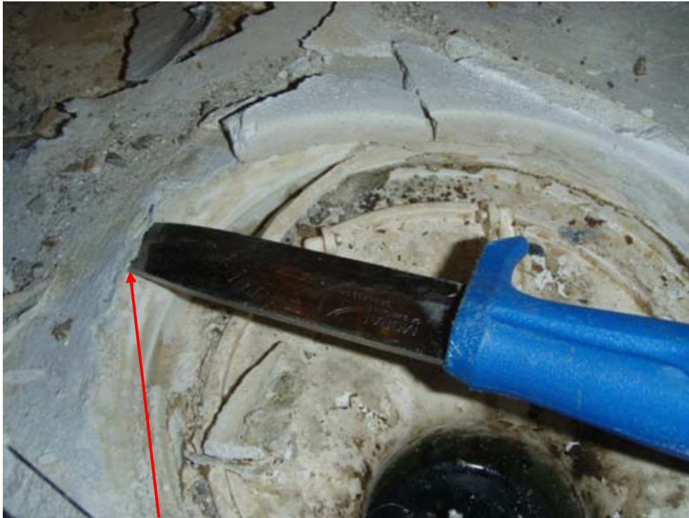
Fotografi 35. Fiberduk och vätskebaserat tätskikt slutar på golvbrunnens fläns och har ingen vidhäftning mot underlaget. Vatten kan rinna/tryckas/sugas rätt in i golvkonstruktionen.
