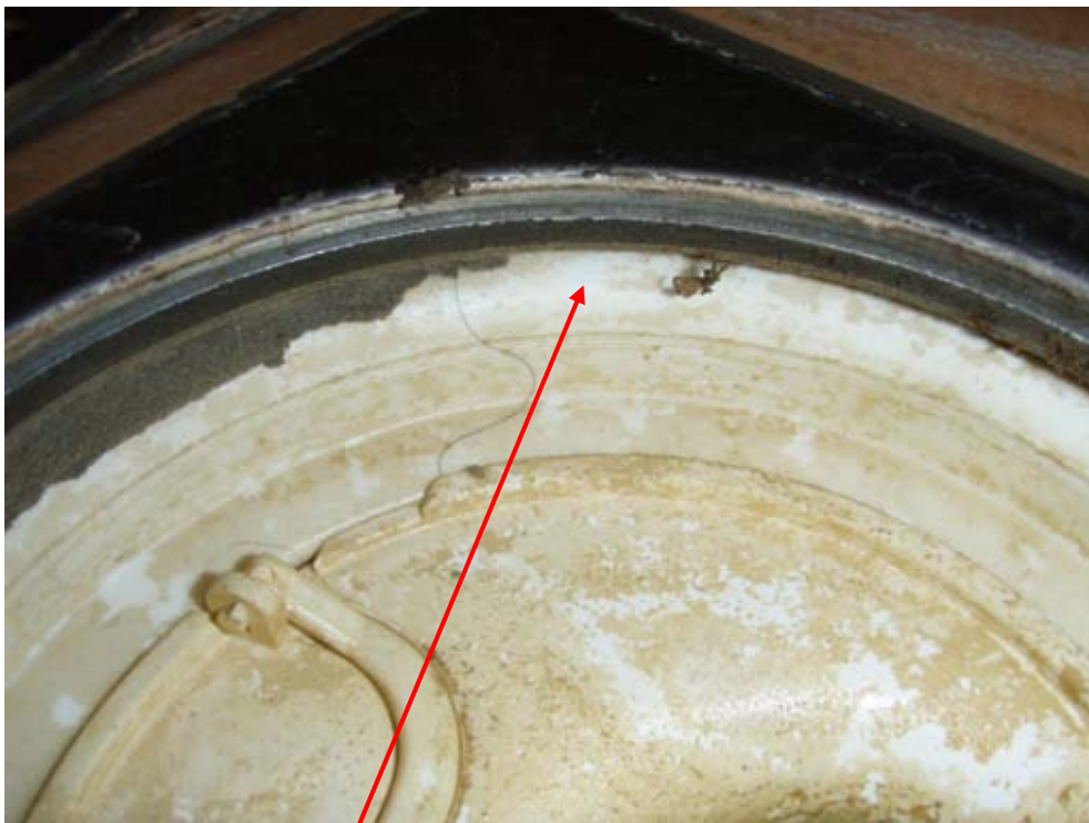
Fotografi 40. Golvbrunn under duschplats. Brunnsmanschett och klämring saknas. Inget synligt tätskikt är applicerat på golvbrunnen.
