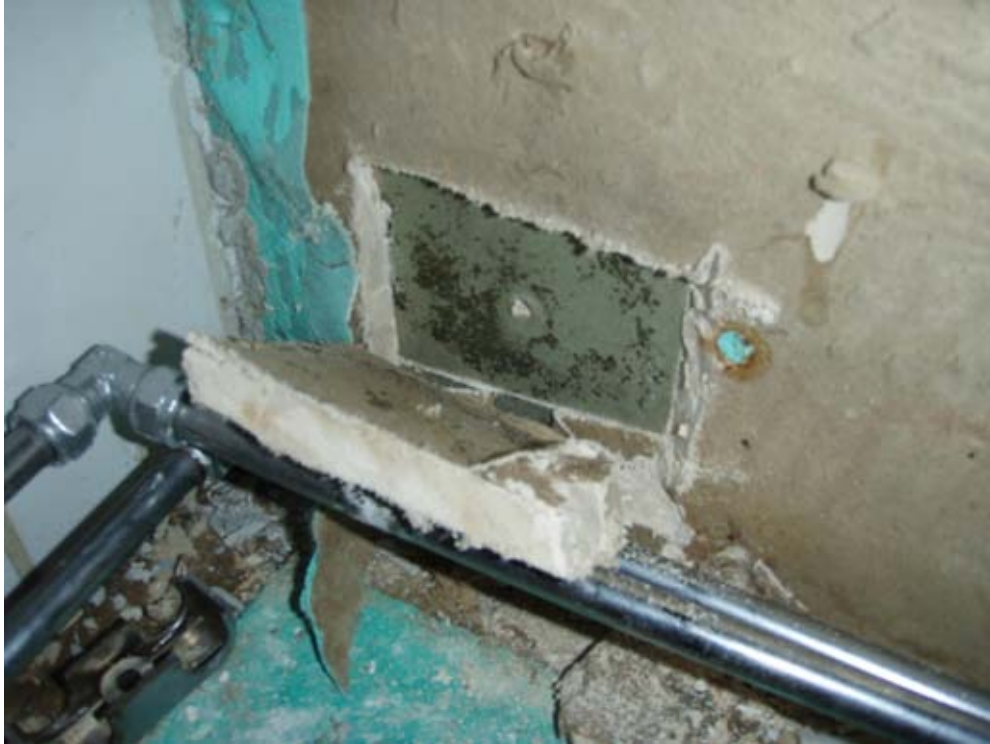
Fotografi 27. Mikrobiell påväxt på gipsskivan (mätpunkt 2).
