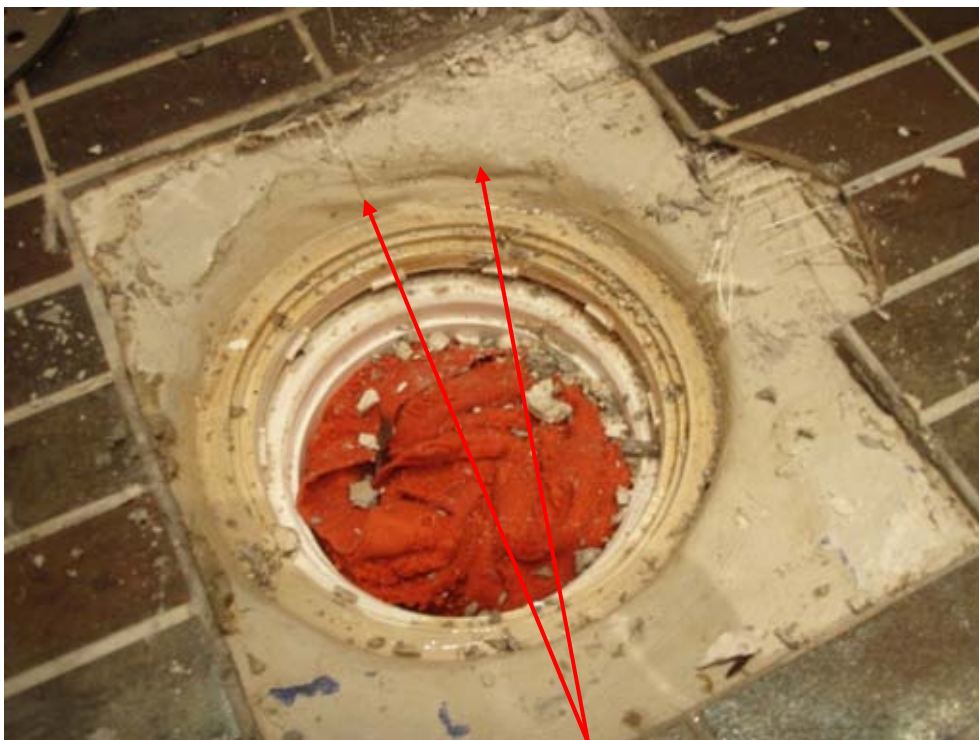
Fotografi 51. Översiktsbild vid rivning. Dålig vidhäftning mellan tätskikt och underlag (bubblor).
