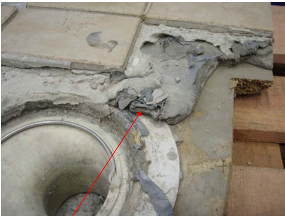
Fotografi 3. Spackel och silvertejp på golvbrunnens fläns under brunnsmanschetten.
