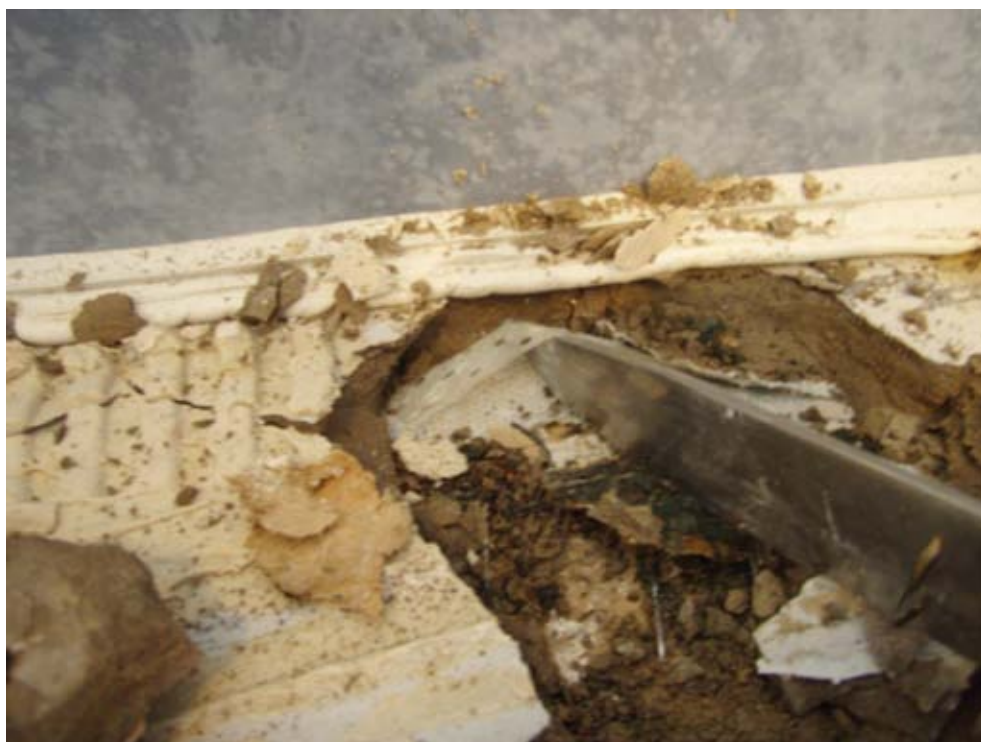
Fotografi 9. Dålig vidhäftning mellan tätskiktsremsa och tätskikt (mätpunkt 2).
