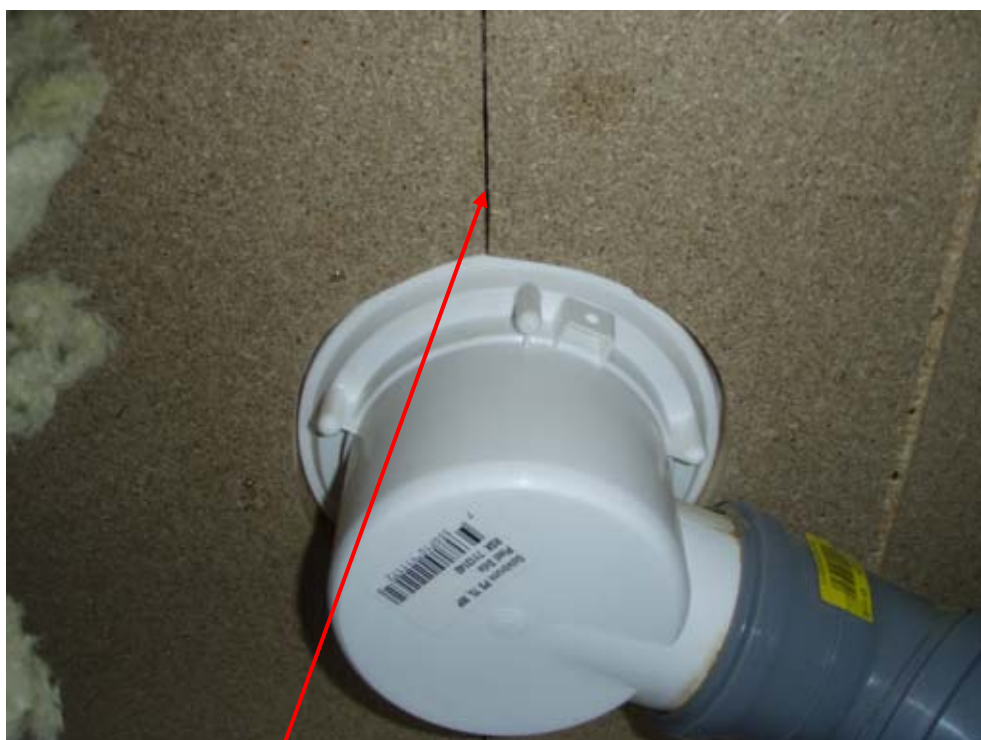
Fotografi 54. Golvbrunn monterad i skivskarv utan kortlingar. Golvspånskiva ej avsedd för våtrum.
