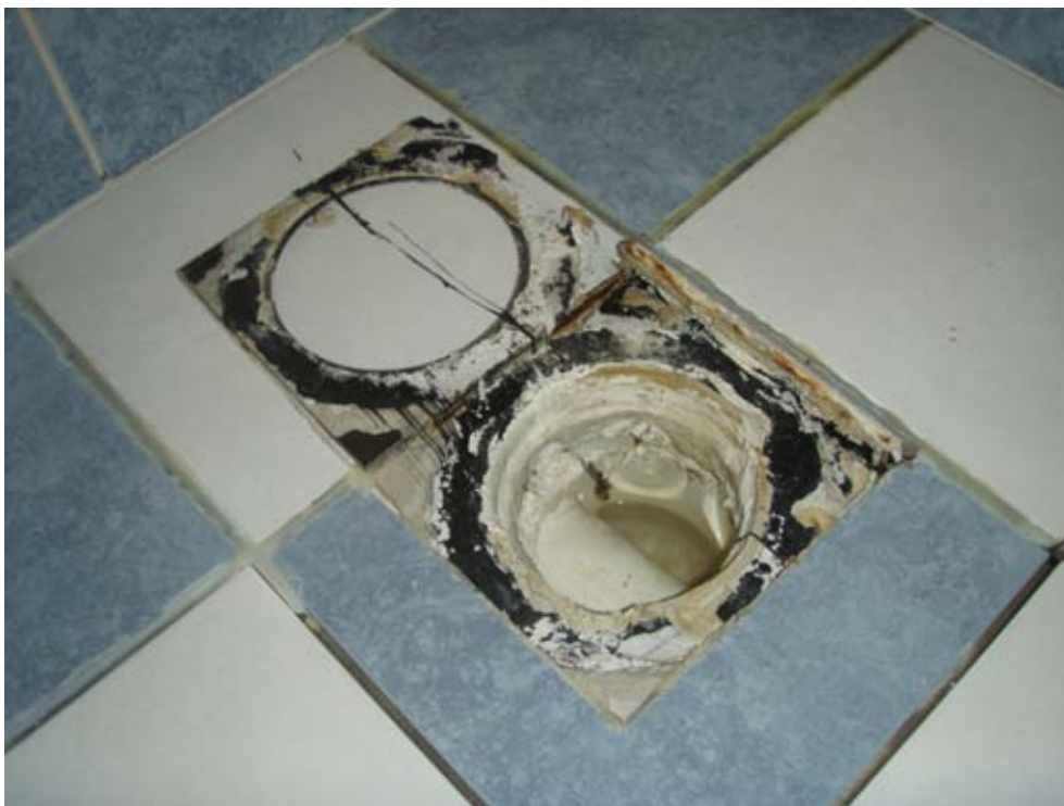
Fotografi 12. Svart brunnsmanschett/massa med dålig vidhäftning mot golvbrunn (mätpunkt 3).
