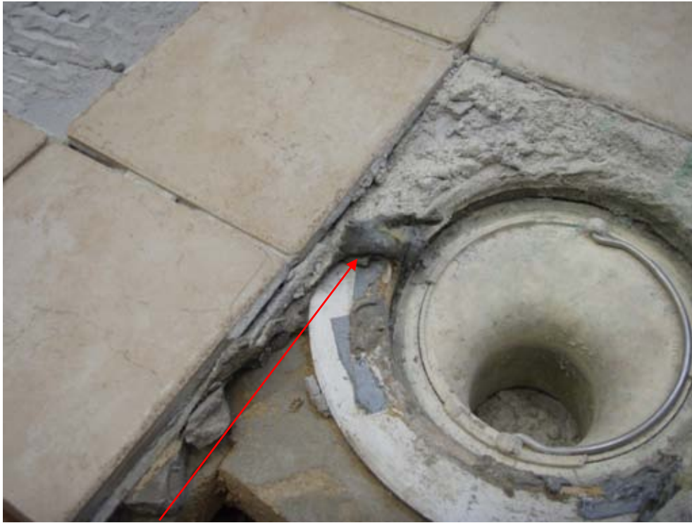
Fotografi 4. Spackel och silvertejp på golvbrunnens fläns under brunnsmanschetten.
