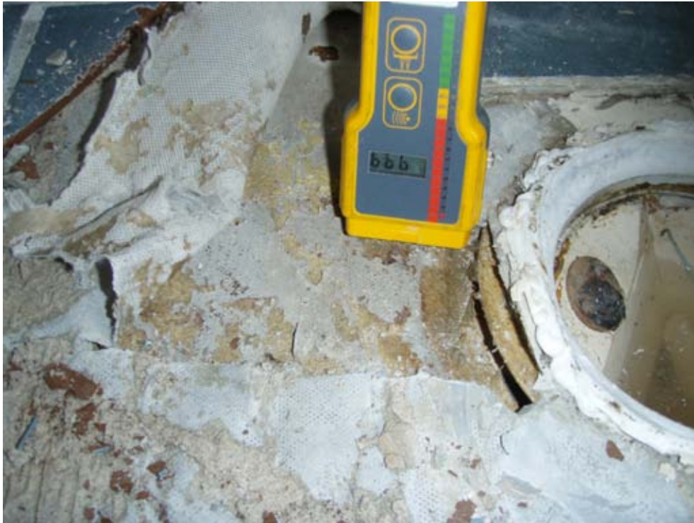
Fotografi 20. Golvspånskivan var fibermättad i anslutning till golvbrunnen (Fk >0,28 kg/kg)
