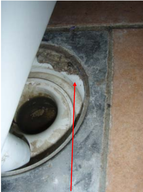
Fotografi 39. Golvbrunn under badkar. Brunnsmanschett och klämring saknas. Inget synligt tätskikt är applicerat på golvbrunnen.
