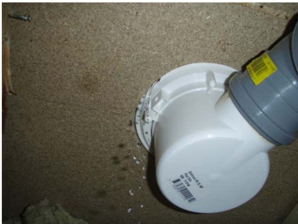
Fotografi 55. Kraftigt läckage i anslutning till golvbrunnen vid provning av golvbrunnens täthet.
