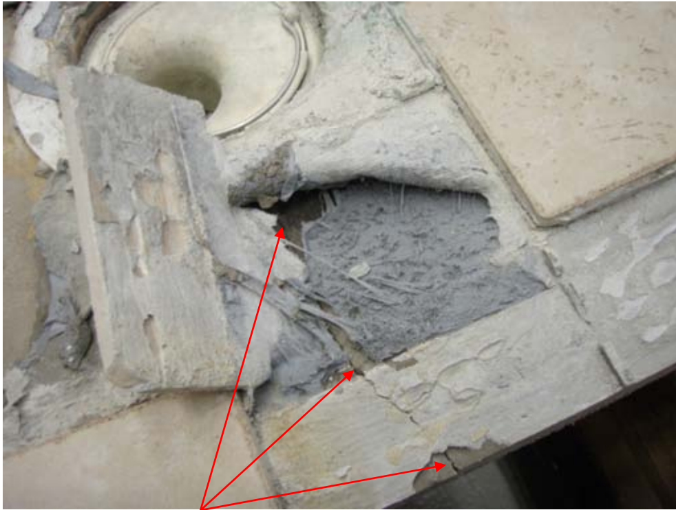
Fotografi 6. Spricka i spackel vid skivskarv. Inget synligt rosa skikt under tätskiktsmassan eller under brunnsmanschetten.
