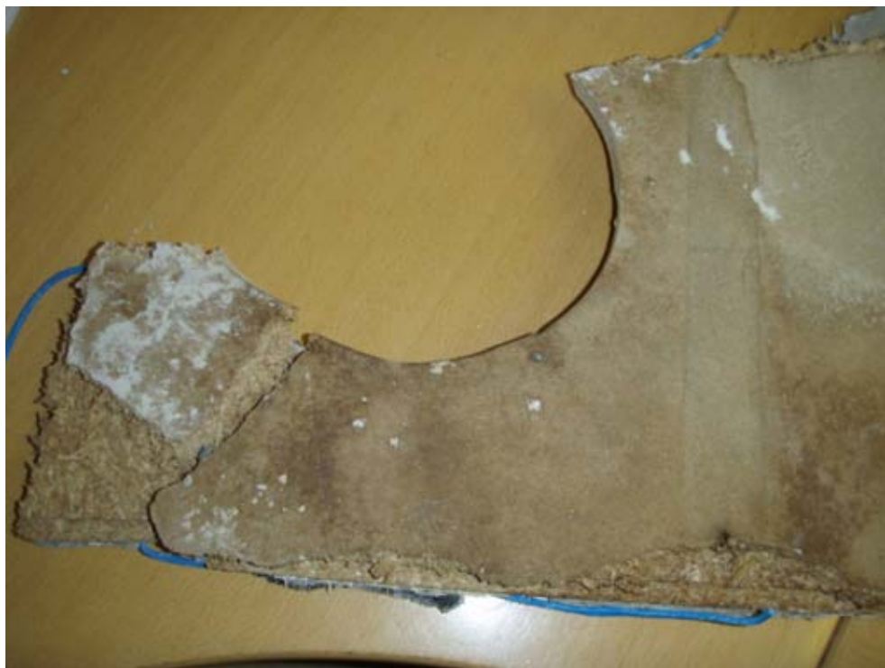
Fotografi 31. Kortlingar mellan träreglarna i anslutning till golvbrunnen saknas. Golvspånskivan är en vanlig golvspånskiva och inte en skiva som är avsedd för våtrum.
