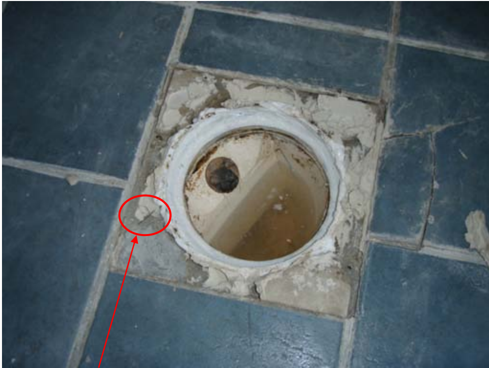
Fotografi 16. Spricka i tätskiktet där vatten läckt in i konstruktionen.
