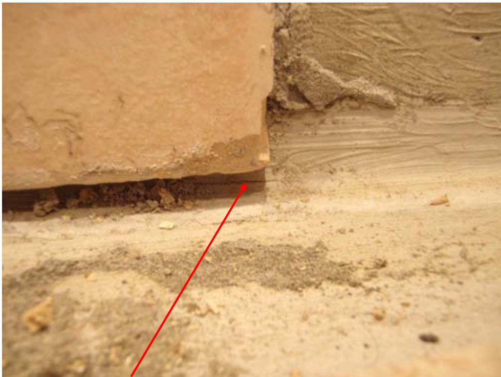
Fotografi 43. Sprickor i tätskiktet i anslutning mellan golv och vägg.
