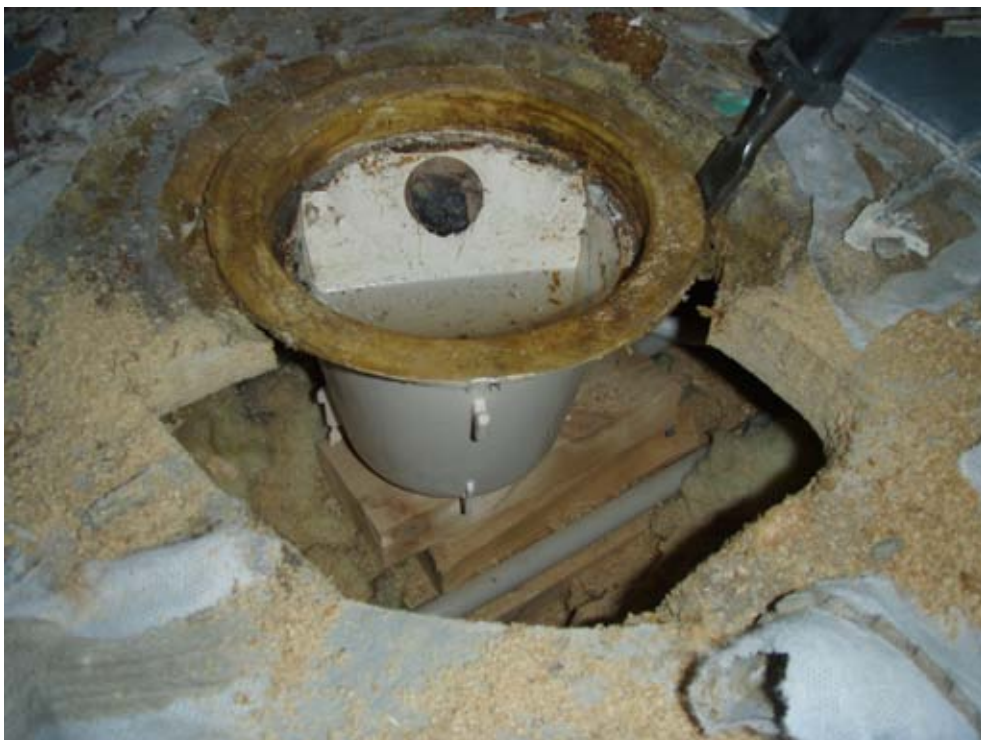
Fotografi 21. Golvbrunnen var inte förankrad i golvspånskivan. Reglar och kortlingar saknades helt i anslutning till golvbrunnen.
