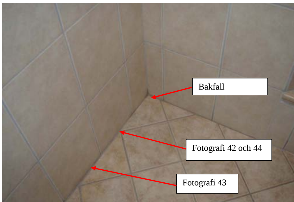
Fotografi 41. Översiktsbild. Bakfall på golv vid vägghörn mellan golv, vägg och bubbelbadkar.
