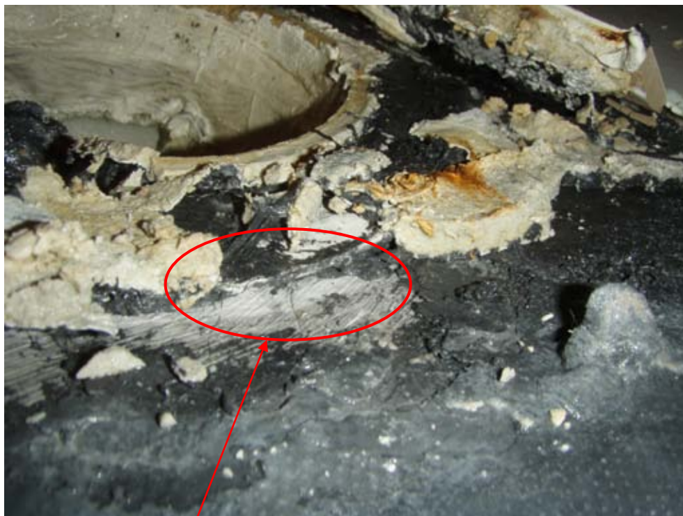
Fotografi 14. Golvbrunnens fläns ej i nivå med vätskebaserat tätskikt (mätpunkt 3).
