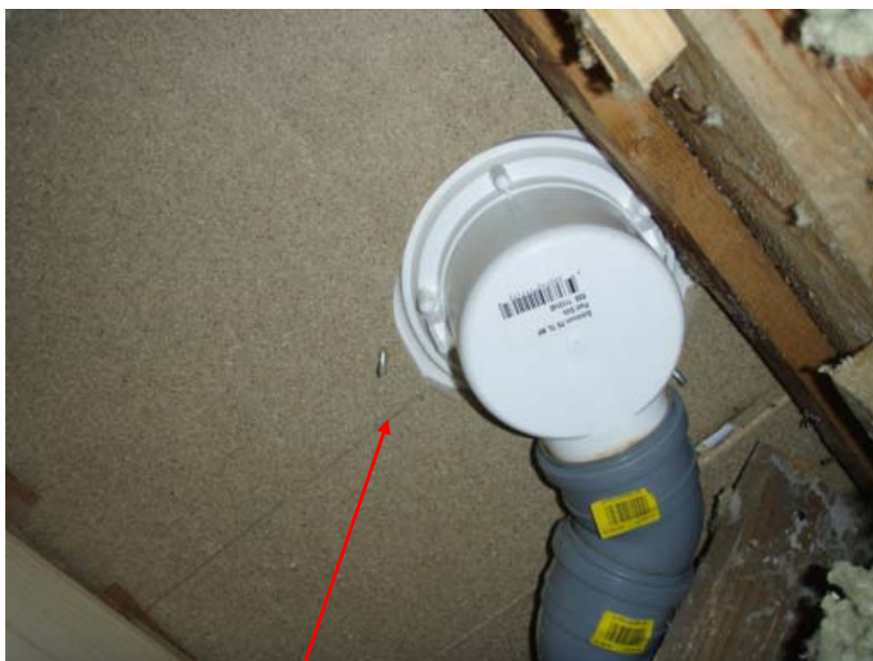
Fotografi 47. Golvbrunn monterad i skivskarv utan kortlingar. Golvspånskiva ej avsedd för våtrum.
