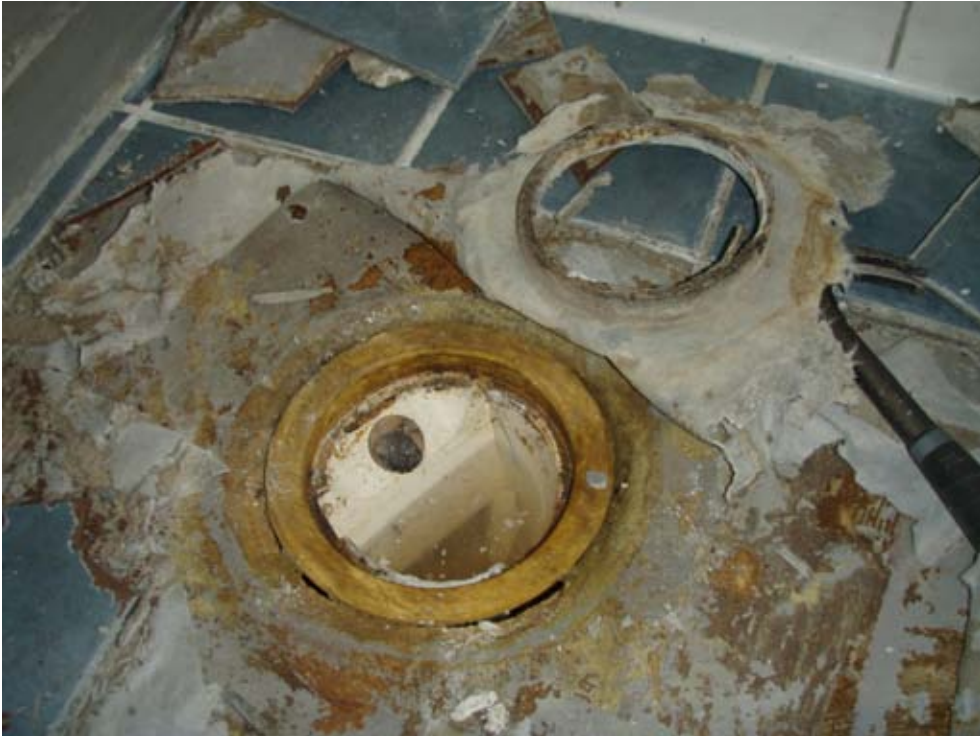
Fotografi 19. Klämring och tätskikt satt helt löst. Tätskikt direkt på golvspånskiva. Torkat lim och tejp på golvbrunnens fläns.
