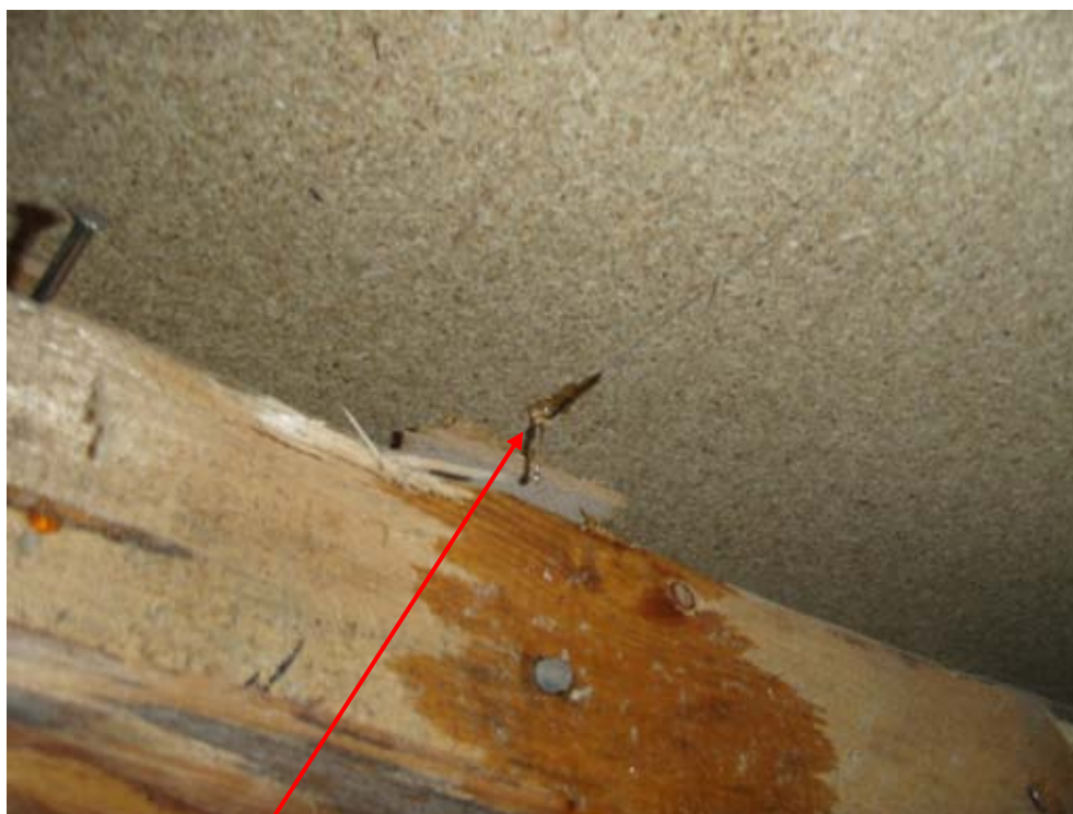
Fotografi 57. Kraftigt läckage i skivskarv vid provning av golvbrunnens täthet (närbild).
