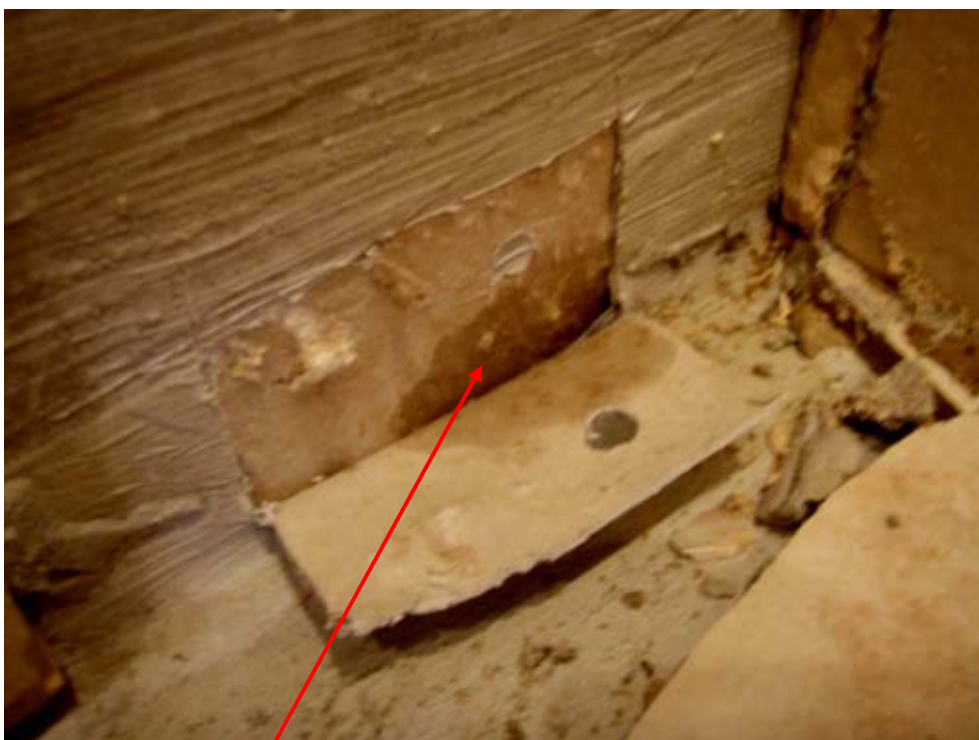
Fotografi 44. Fritt vatten på gipsskivan bakom tätskiktet.
