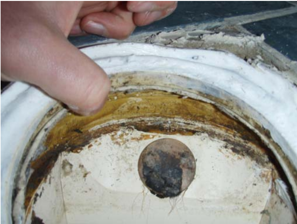
Fotografi 18. Klämring och tätskikt satt helt löst.
