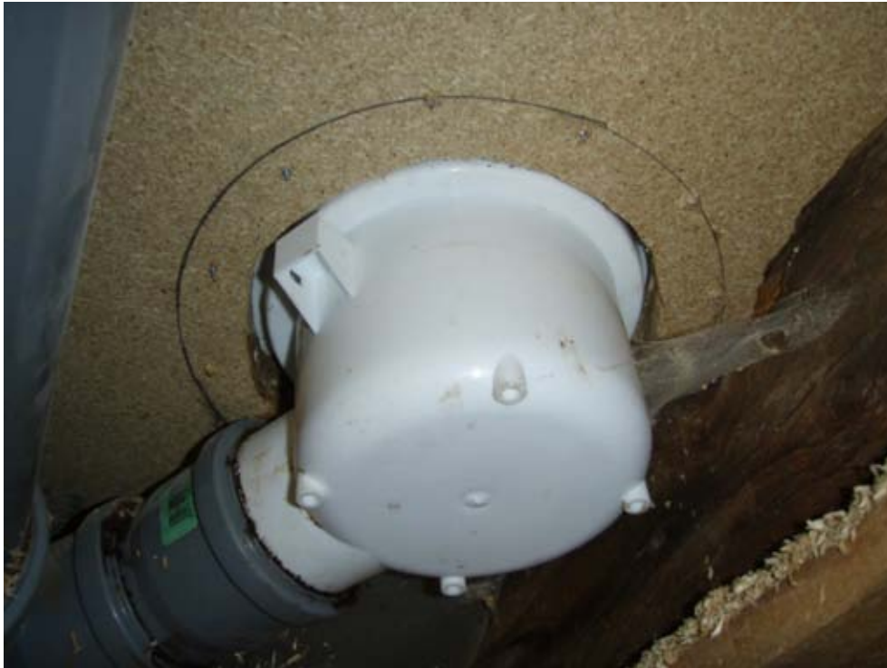
Fotografi 37. Golvbrunn under duschplats. Golvbrunn monterad i en vanlig spånskiva utan förstärkning av regler och kortlingar.
