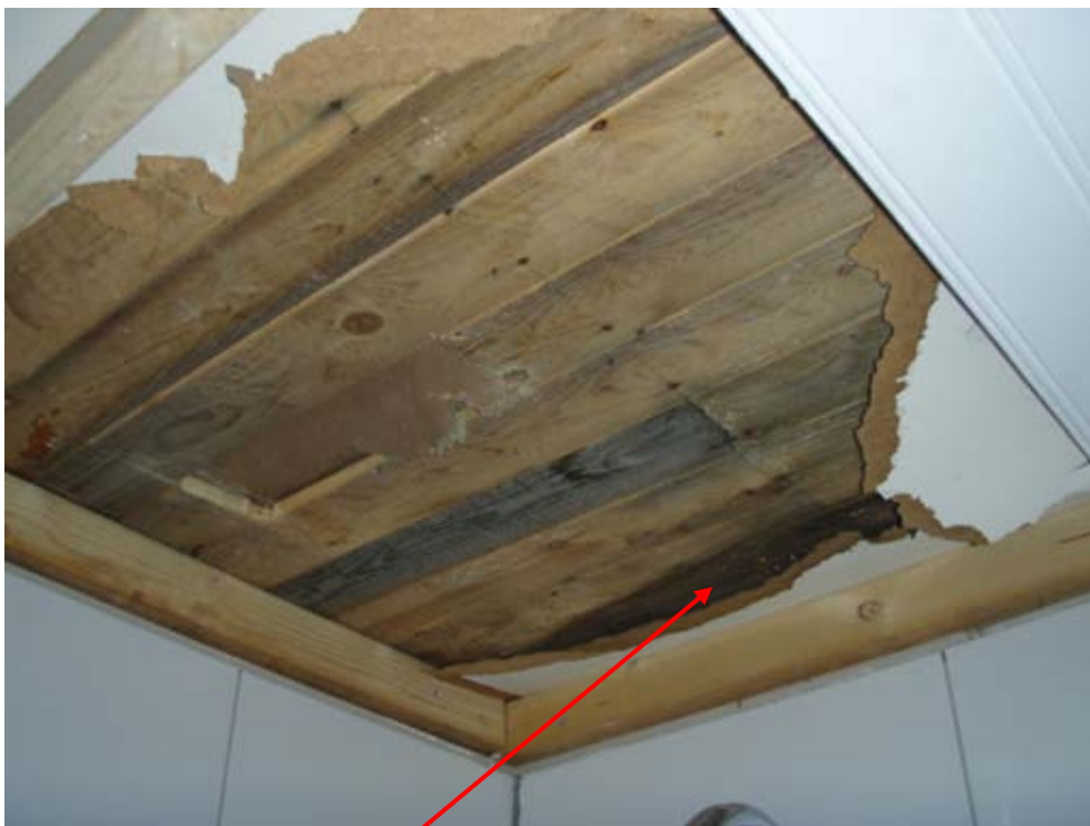
Fotografi 46. Undersida bjälklag rakt under våtrum. Missfärgningar, hög fuktkvot och unken lukt.
