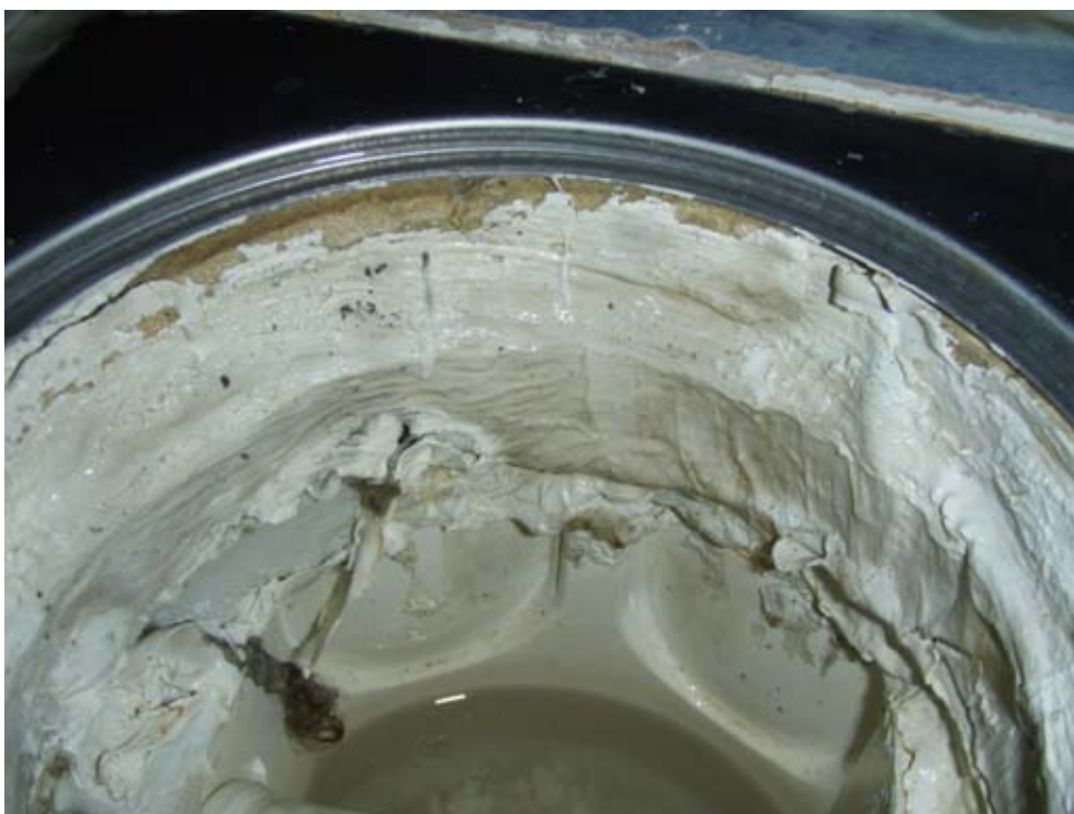
Fotografi 11. Vit tätskiktsmassa applicerad ner i golvbrunn (mätpunkt 3). Klämring saknas.
