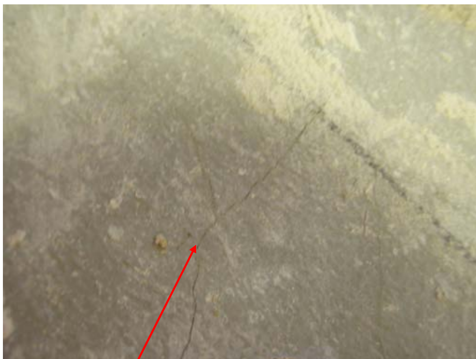
Fotografi 32. Sprickor i tätskiktet.
