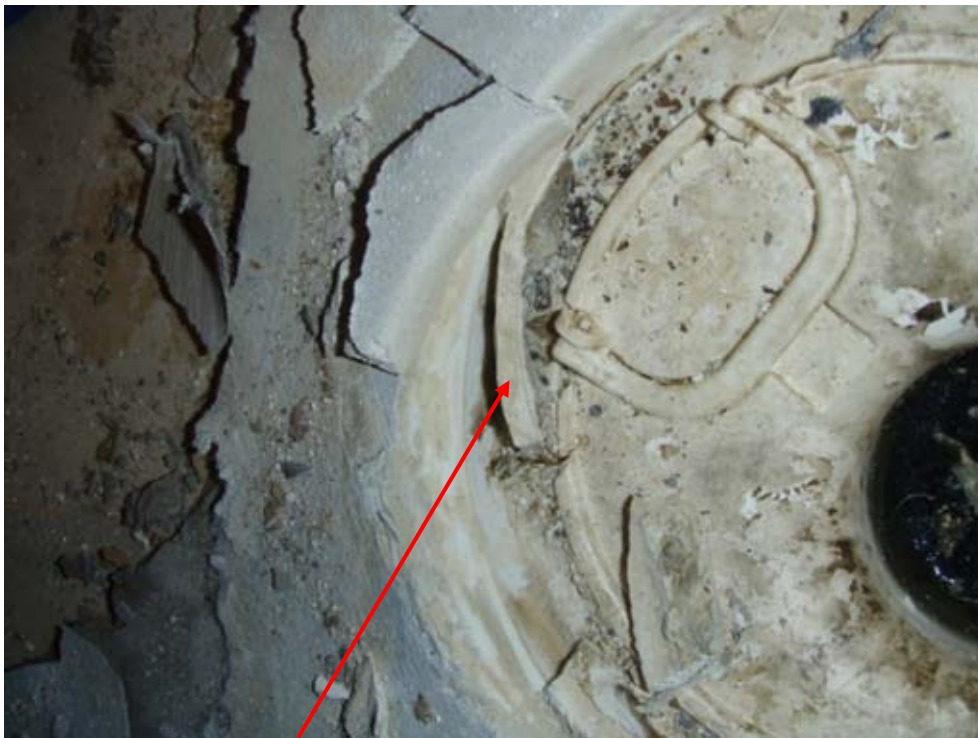
Fotografi 34. Endast fästmassa förekom mellan golvbrunnen och den rostfria plåten där klämring och tätskiktsmanschett skulle varit monterad. Observera att fästmassan är kapillär-sugande.
