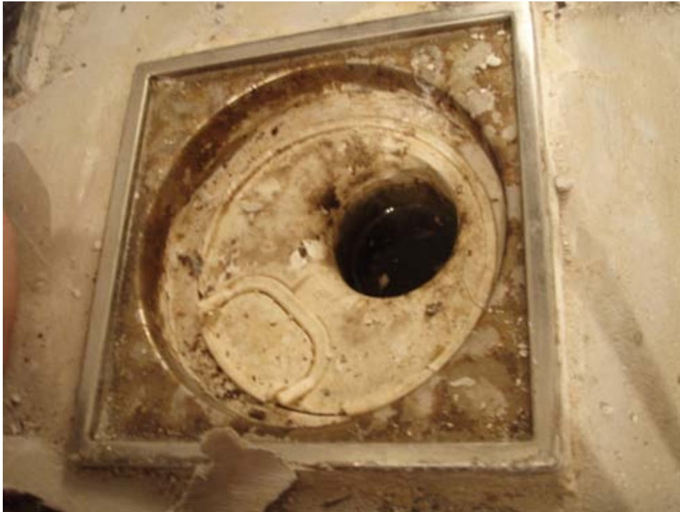
Fotografi 33. Rostfri plåt i anslutning till golvbrunnen innan friläggning.
