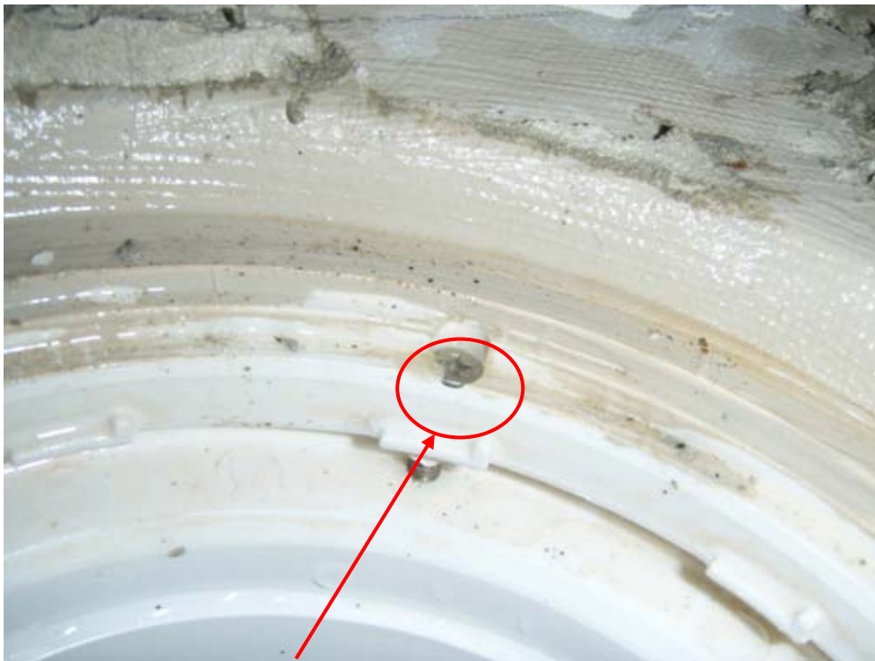
Fotografi 58. Fastskruvad klämring utan tryck vid kontroll.
