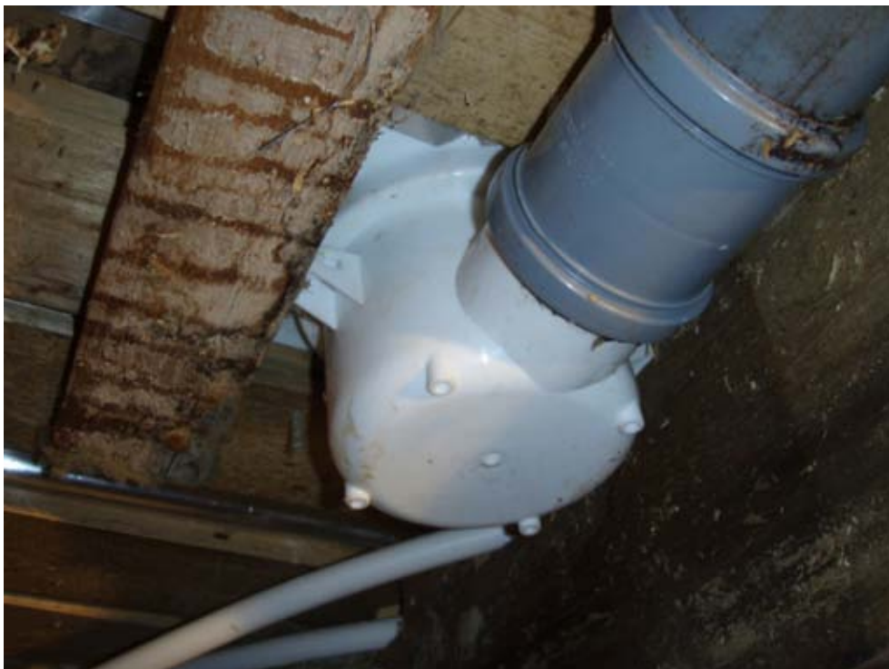
Fotografi 38. Golvbrunn under badkar. Golvbrunn dåligt fastsatt i underlaget och saknar stöd av kortlingar. Gipsskiva som underlag ovan träplank.
