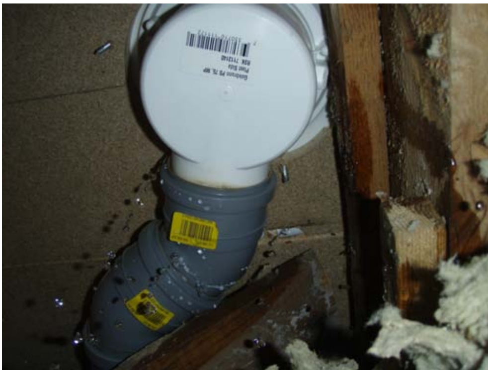
Fotografi 48. Kraftigt läckage på flera platser vid provning av golvbrunnens täthet.
