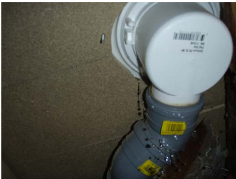
Fotografi 49. Kraftigt läckage på flera platser vid provning av golvbrunnens täthet.
