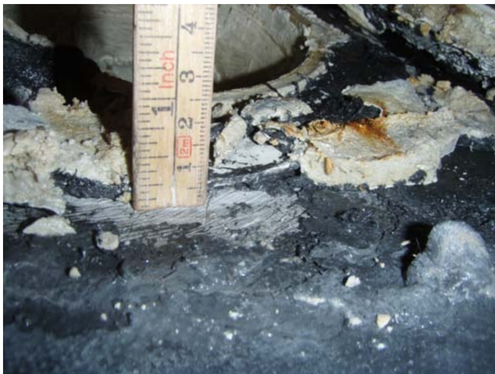
Fotografi 15. Golvbrunnens fläns ej i nivå med vätskebaserat tätskikt (mätpunkt 3).
