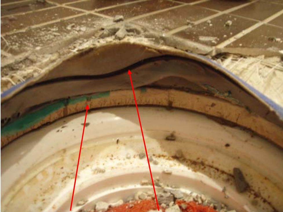
Fotografi 52. Gipsskiva på golvbrunnsfläns. O-ring mellan golvbrunn och tätskiktsmanschett.
