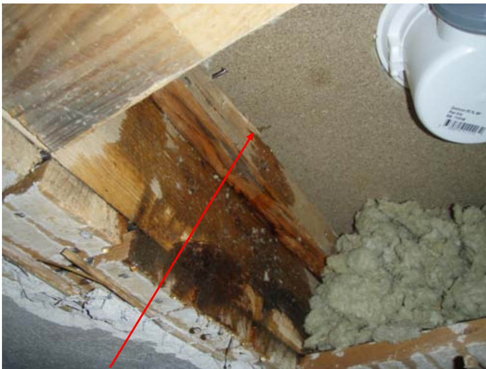
Fotografi 56. Kraftigt läckage i skivskarv vid provning av golvbrunnens täthet (översiktsbild).
