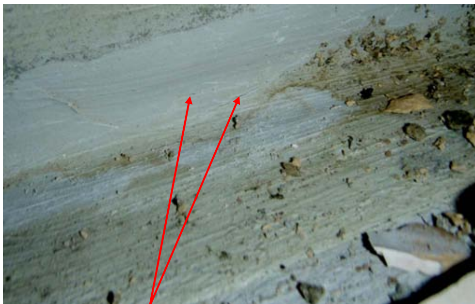
Fotografi 42. Sprickor i tätskiktet i anslutning mellan golv och vägg.
