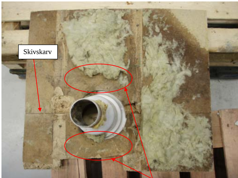
Fotografi 7. Golvbrunn monterad i skivskarv. Kortlingar har inte varit monterade mellan träreglarna i anslutning till golvbrunnen.
