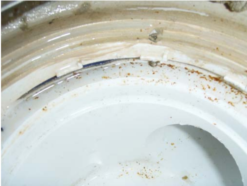
Fotografi 50. Cirka 2 mm glapp mellan fastskruvad klämring och golvbrunn vid kontroll.
