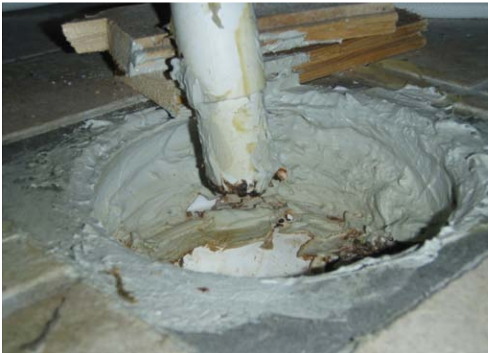
Fotografi 45. Klämring och brunnsmanschett saknas. Det vätskebaserade tätskiktet är applicerat ner i golvbrunnen.
