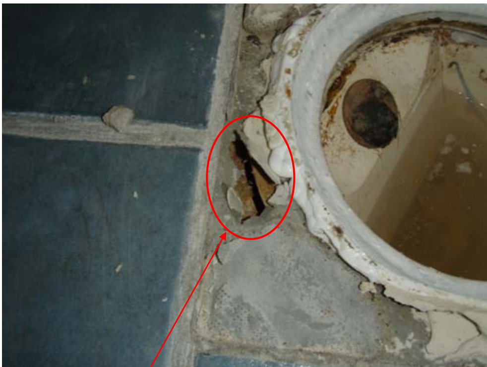
Fotografi 17. Underliggande material saknas under tätskiktet mellan golvbrunn och golvspånskiva (tätskiktet "hänger" i luften). Även glipa mellan golvspånskiva och golvbrunn.
