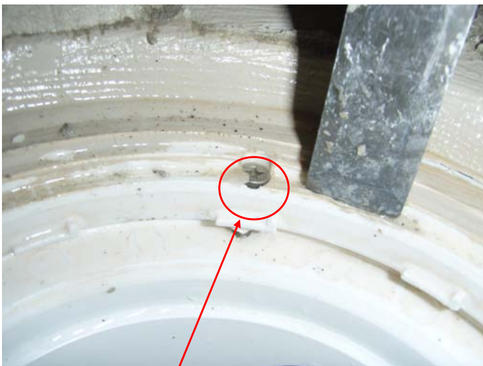
Fotografi 59. Fastskruvad klämring med tryck vid kontroll (glapp ca 1-2 mm).
