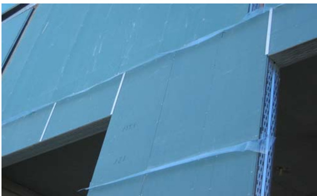
Figur 13. För att undvika att vatten kommer in har plastfolieremсор monterats i skarvarna mellan utegipsskivorna för att leda bort regnvatten som rinner på fasaden.
