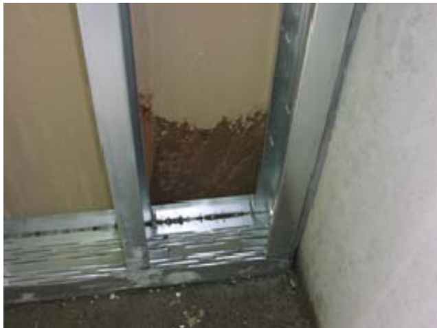
Figur 14. Utvändig gipsskiva har fuktats upp och missfärgats av regnvatten som trängt in genom otätheter mellan betongstomme och utfackningselement.
