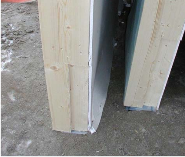
Figur 6. Projekteringsfel eller transportskada?
