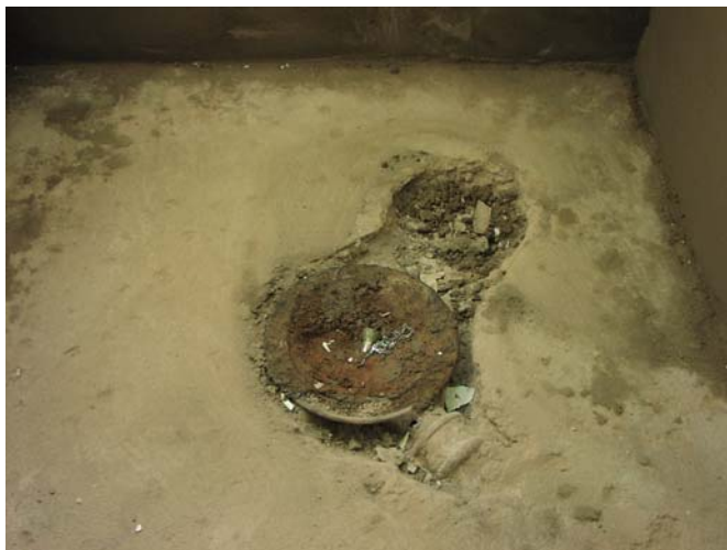
Bild 7.13 Erfarenheten är att gamla golvbrunnar av gjutjärn ofta är i behov av utbyte. Förutom att bättre fuktsäkerhet uppnås med en ny och godkänd golvbrunn är fördelen med att nya golvbrunnar har vattenlås som medger rengöring av golvbrunnen på ett enkelt sätt.
