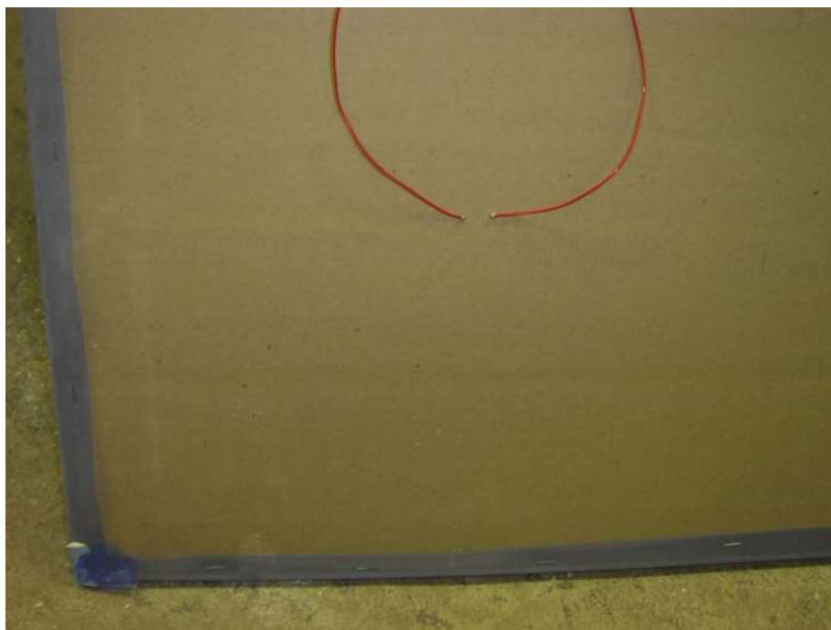
Fotografi 5. Förlängningskabel med pålödda mässingsspikar i gipsskiva.
