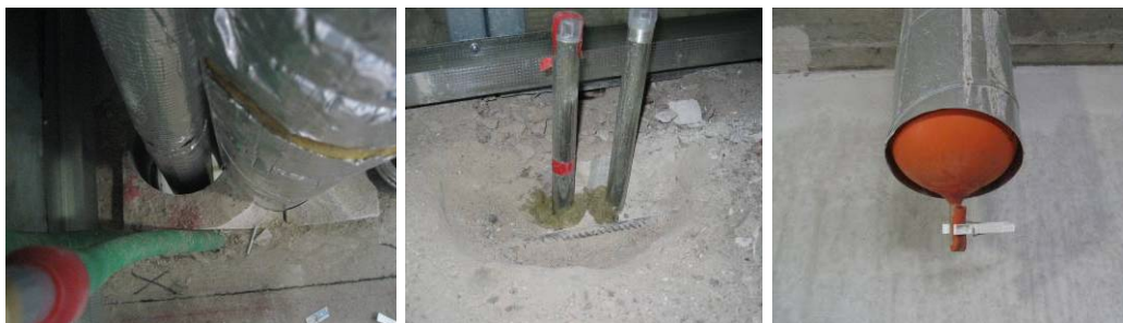
Figur 11 Hål kring genomföring i bjälklag, tätning med mineralull kring rör samt ventilationsrör tätat med ballong.
