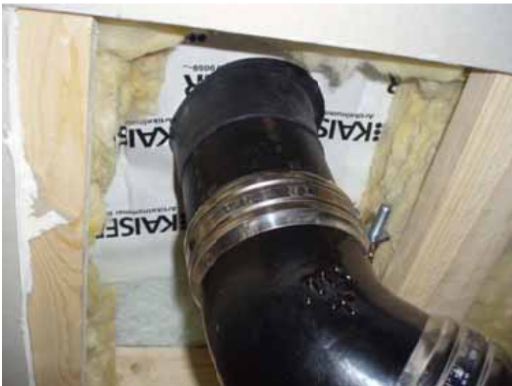
Figur 44 Stös kring avloppsluftare.
