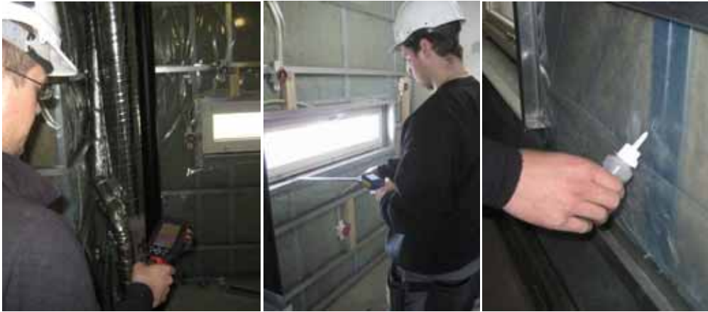
Figur 56 Läckagesökning med värmekamera, lufthastighetsmätare och rökgas.
