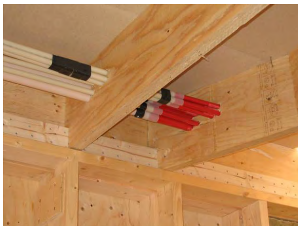
Figur 69. Genomföringar av el-dragning vid brandcell intill trapphus.
