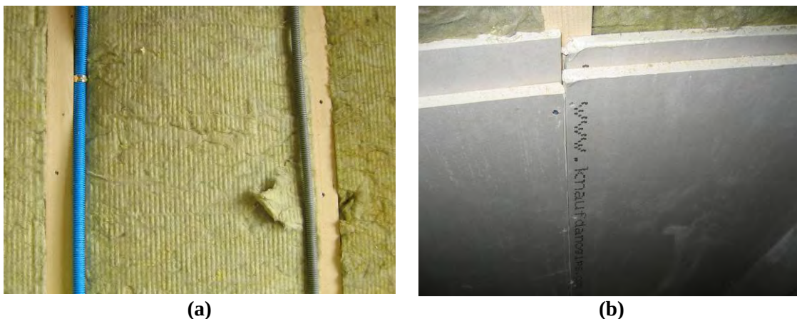
Figur 39. (a) Lägenhetsskiljande vägg med isolering. (b) Avståndet mellan väggreglarna har inte varit exakt anpassat till väggsnivåerna.
