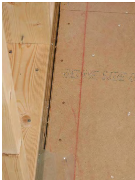
Figur 53. Fog mellan bärande regelverk i yttervägg och bjälklagselement. Med tekniken att klämma ihop fogen med väggstagen och ingen minustolerans på bjälklagselementet uppstod ingen spalt. Väggen har ett lager med 45 mm minull och 2x15 gipsskivor innanför fogen.
