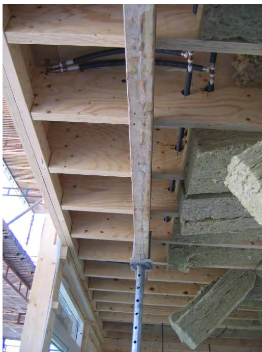
Figur 52. Monterat bjälklagselement sett underifrån. Parti med ledningsdragning är inte isolerad.
