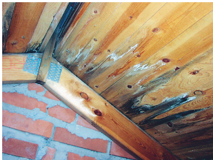
Detta tak har skadats av vattenläckage vid gaveln. Vattnet har sugits in i råsponten.
