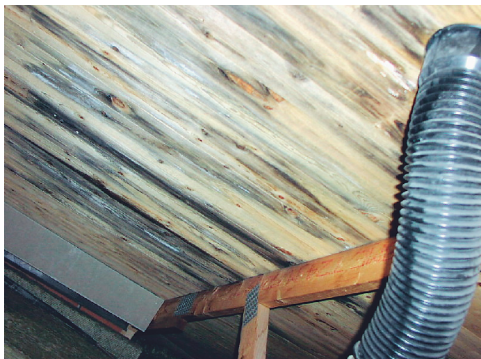
Hög fuktighet kan orsaka svällning och sönderbrytning av takpanelen.
